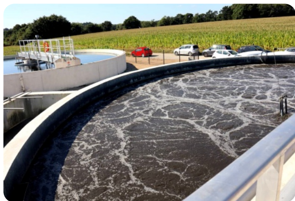
Pomiar tlenu rozpuszczonego w komorze napowietrzania
